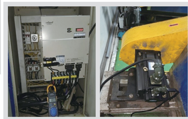
제일** 집진기 서보 모터펌프(11KW)
